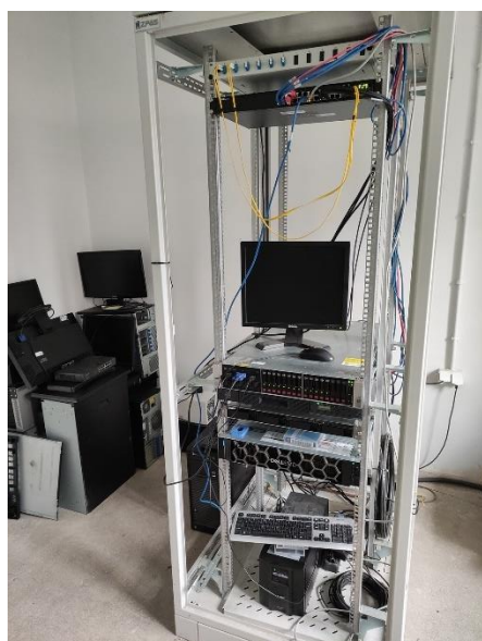
Zdjęcie nr 9: Szafa serwerowa
